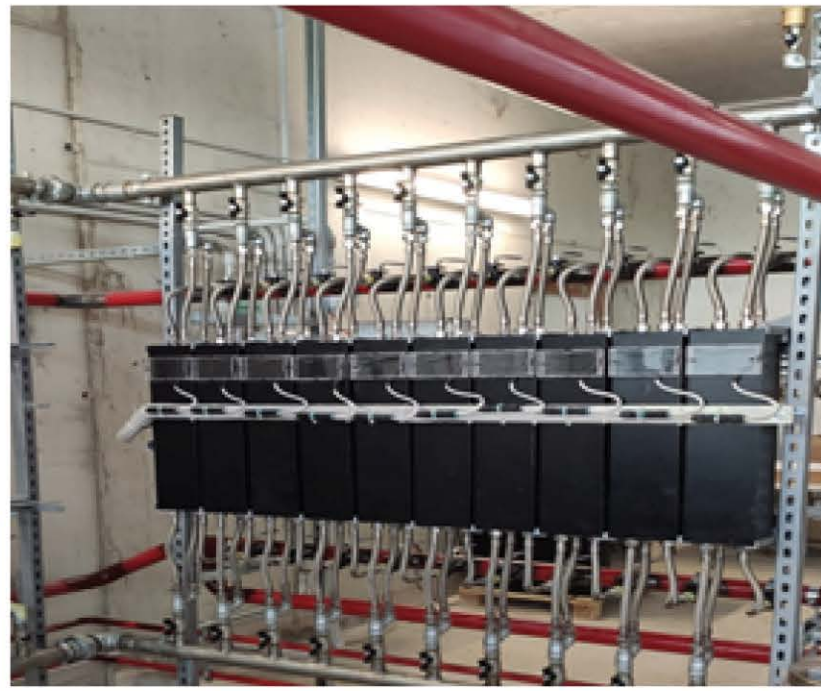
Esempio di un sistema a 10 Moduli con resa di 17 520 Kwh annui realizzato a Mantova - ITALIA Example of a 10 modules 17520 Kwh year electrical production plant in Mantova - ITALY
